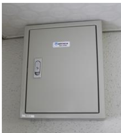
電話接続端子盤
