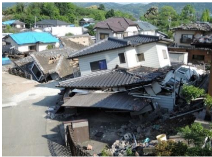
熊本地震における建物被害状況
